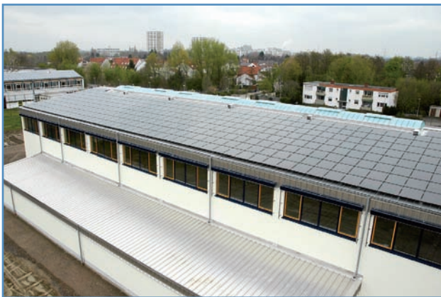
Photovoltaikanlage auf dem Dach des Schulzentrums Edigheim
