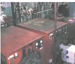
Alte Heizungsanlage des Kanalbetriebs am Unteren Rheinufer
