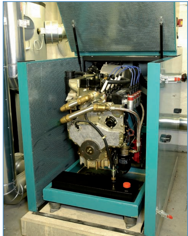
BHKW in der Rupprechtschule
