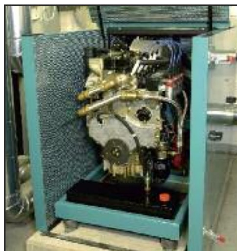
BHKW in der Rupprechtschule
