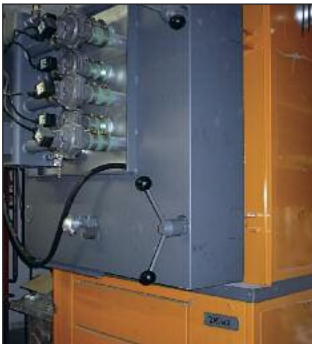
Holzhackschnitzel-Kessel in der Feuerwache Nord
