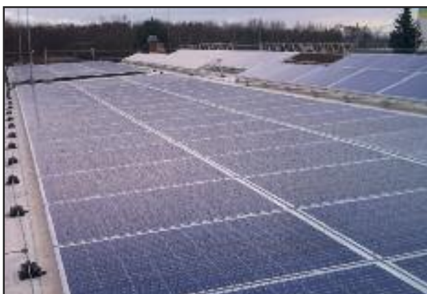
Vom KlimaAktiv-Sparbrief finanziert: PV-Anlage auf dem Wasserwerk 2
