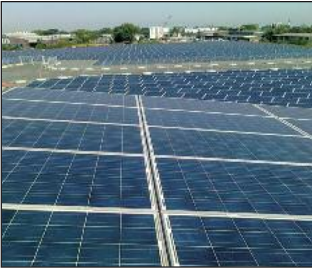
2012 errichtete PV-Anlage auf der Halle und dem Gelände Ofenhallendamm
