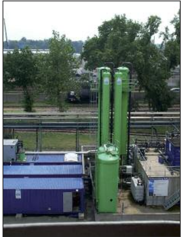
Anlage Grundwassersanierung Raschig
