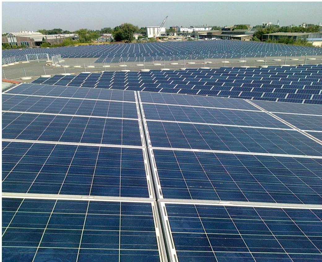
Bild 24: Die im Juni 2012 errichtete PV-Anlage auf der Halle Ofenhalendamm (325 kW p ), Freifläche im Hintergrund: Bereich 4-15 Umwelt
