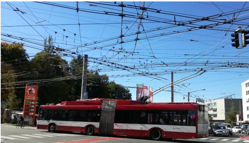
Abbildung 31: Fahrleitungssystem am Knotenpunkt (O-Bus Salzburg) © Julius Rücker
