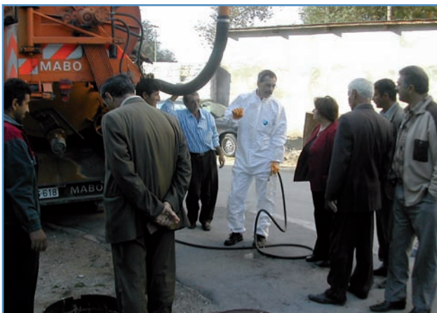
Praktische Schulung am Kanalspülfahrzeug in Sumgait durch einen Mitarbeiter der Ludwigshafener Stadtentwässerung
