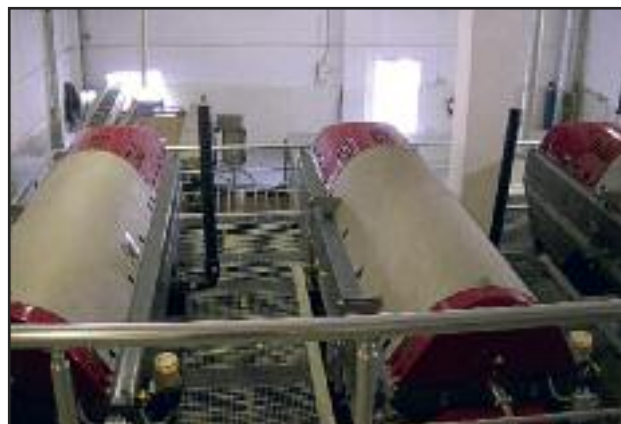
Neue Zentrifugen zur Schlammentwässerung in der Kläranlage in Baku
