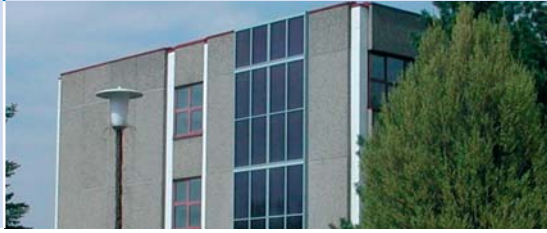
Fassadenkollektoranlage zur Warmwasserversorgung von Lehrküche und Sporthalle der Hotelfachschule in Heidelberg
